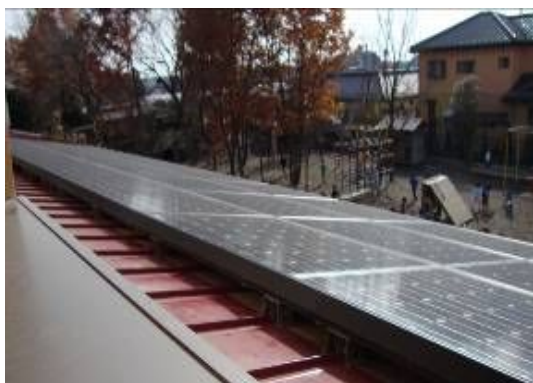
写真 13 屋根の上のソーラーパネル
