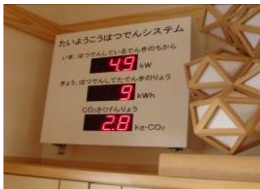
写真 14 発電量などが分かる掲示板
